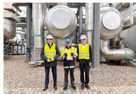
Hier sind (von links nach rechts) vor dem neuen Biomasseheizkraftwerk zu sehen: Dr. Hansjörg Roll (Technikvorstand von MVV), Dr. Georg Müller (Vorstandsvorsitzender von MVV), Uwe Zickert (Geschäftsführer MVV Umwelt).
